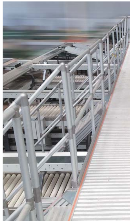
Bridge for Sorting Machine 分拣设备过线梯
